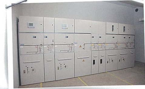
Schaltschränke der Mittelspannungsversorgung in der Betriebszentrale Staldbach.
