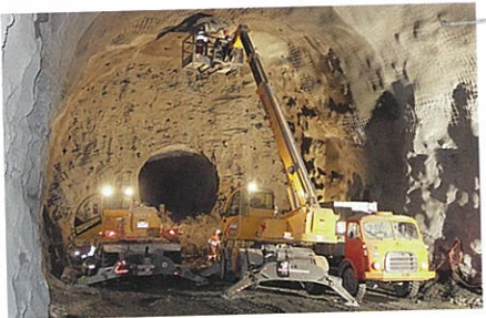
Die künftige Nordröhre des Tunnels Visp entsteht. Der bestehende Sondierstollen von 4.75 m wird auf 10.80 m ausgeweitet.
