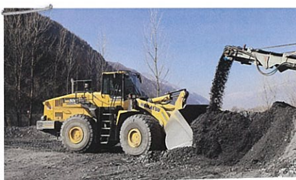
Das gebrochene und aufbereitete Material aus dem Tunnel Visp wird auf den Baustellen für Trasseeschüttungen verwendet oder per Förderband auf die Deponie Goler transportiert.
