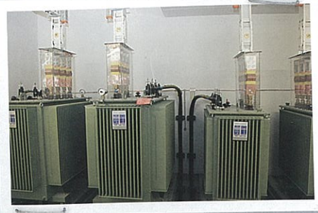
Transformatoren zur Stromversorgung in der Betriebszentrale Grosshüs.
