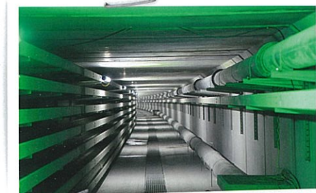
In der Sohle des Tunnels, unter der gesamten Fahrbahn: Begehbarer Werkleitungskanal.
