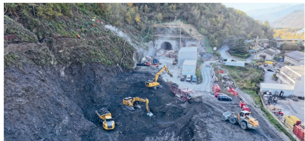
Anstich zum Bau des Erkundungs- und Entwässerungsstollens Lunggi am 21. Oktober 2024. Der Voreinschnitt erreicht den stabilen Felsen im Monat Dezember 2024 und der Tunnel verläuft dann in westlicher Richtung.
